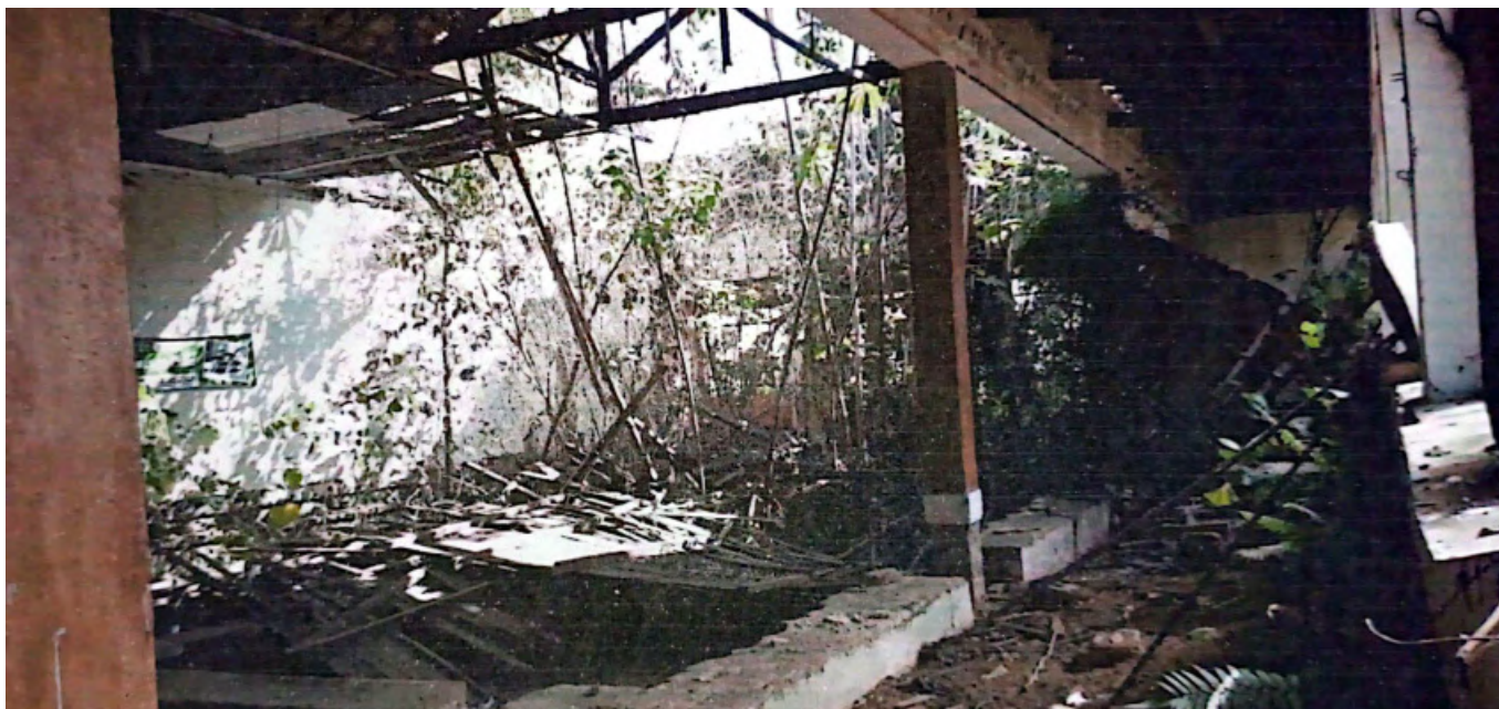
Figura 19: Salão lateral em ruínas. Fonte: Laudo elaborado pela defesa civil de Águas da Prata (2022).
