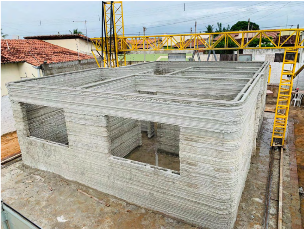
Figura 3: Primeira residência construída a partir de impressão 3D no Brasil. Fonte: Stylo Urbano, site oficial Stylo Urbano. Disponível em: https://www.stylourbano.com.br/3dhomeconstruction-constroi-a-primeira-casa-de-impressao3d-do-brasil/ .
