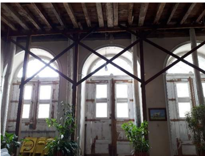
Imagem 8: Interior do Sobrado, hall de entrada e as estacas improvisadas para sustentar a estrutura da edificação. Fonte: autora, setembro 2019
