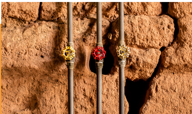
Figura 07 [Instalações Aparentes. Autor: Isabela Slywitch (2023).]
