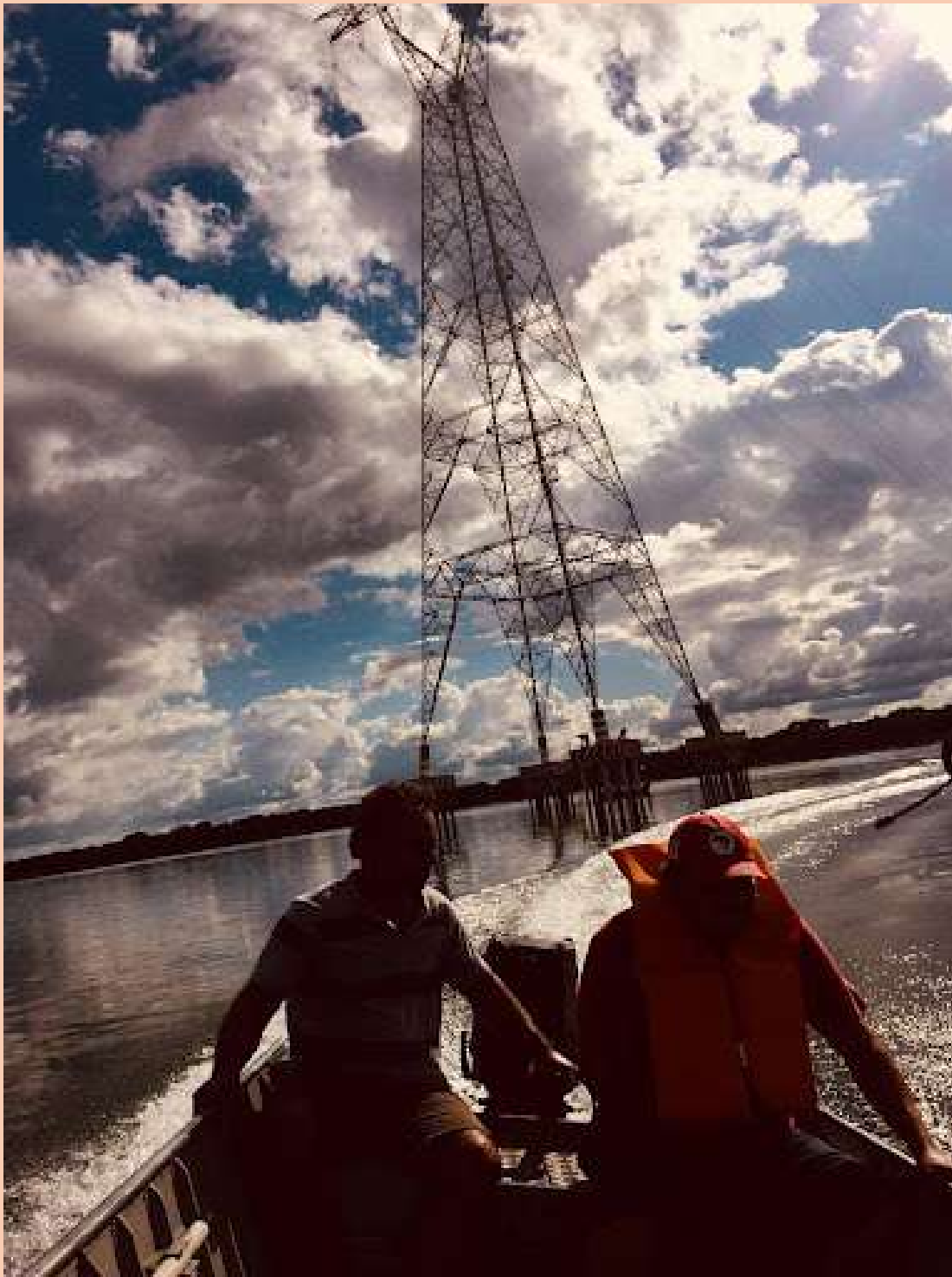
Torres de transmissão de energia no rio Paraná, no Pontal do Paranapanema - SP.
